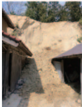
美郷町民家裏崩土（震災付近）
