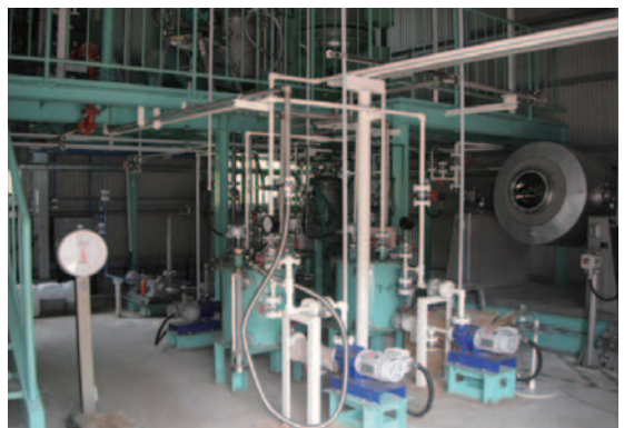
写真3 リグノフェノールプラント
