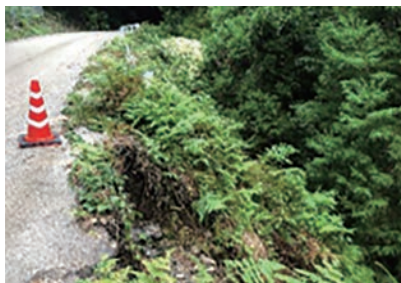
路肩の崩壊状況（海士町）
