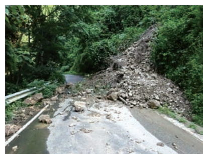
法面の崩壊状況（松江市）
