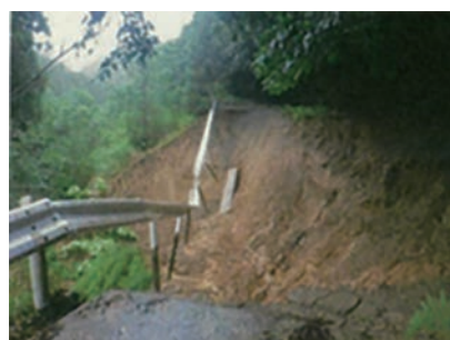
路体の流出状況（出雲市）
