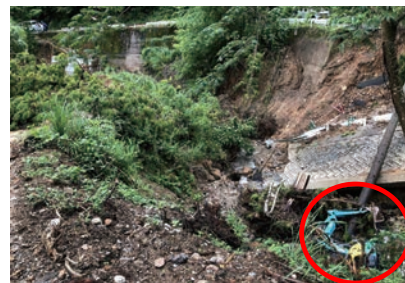
令和2年災の現場にあった重機転倒（隠岐の島町）
