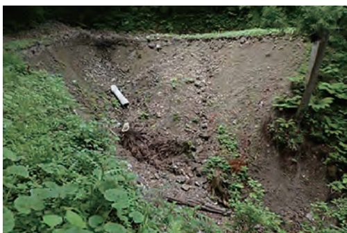
令和3年災 小田支線 被災状況
