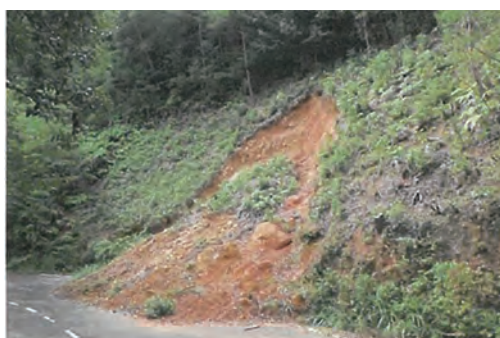
令和3年災 石浦野坂線 被災状況
