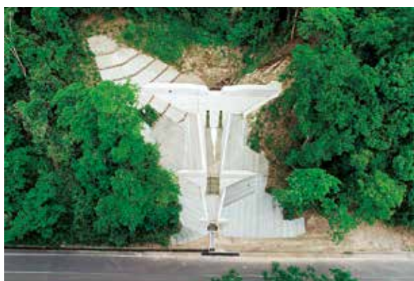
【谷止工による道路の保全（溪間対策）】
