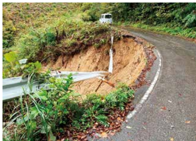
令和6年災 杉戸宇山線(雲南市) 被災状況
