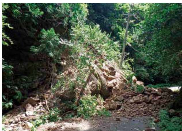
令和6年災 馬見谷線(松江市) 被災状況
