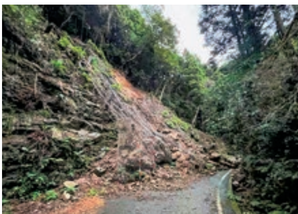
令和6年災 馬見谷線（松江市）被災状況
